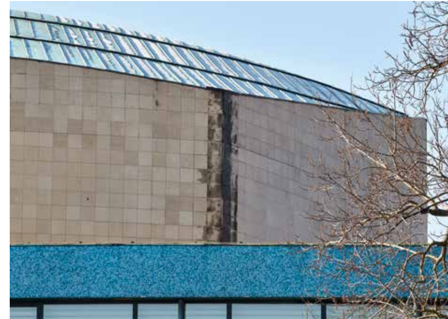
2016 waren in vielen Bereichen der Beethovenhalle Schäden zu sehen, wie auch hier an der Fassade oberhalb des Restaurants DaCapo; heute heißt es Cantos.
