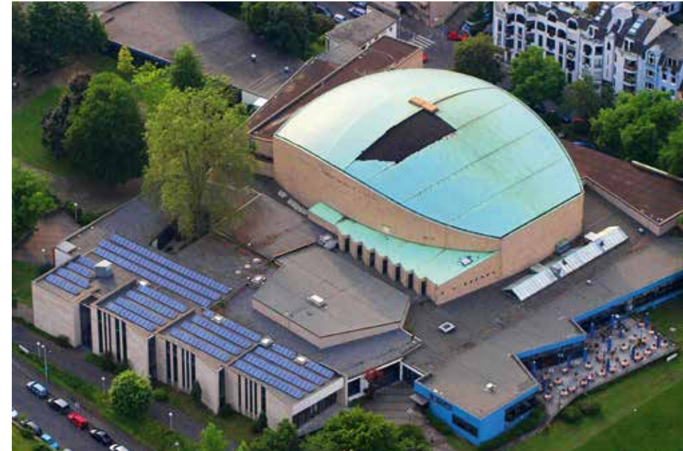
Im Januar 2007 fegte Sturm Kyrill über Bonn. Dabei wurde das Kupferdach der Beethovenhalle beschädigt und anschließend nur notdürftig mit Dachpappe repariert.
